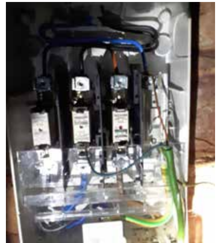
► Lebensgefährliche Stromabnahme vor dem Stromzähler
